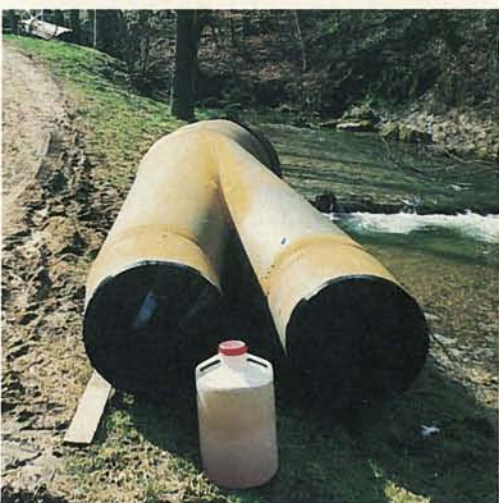
Dieses Hosenrohr führt das Wasser aus den beiden Druckrohren zur Turbine.
