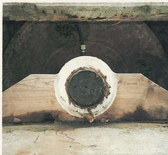
Vue de détail: Palier de l'arbre avec mécanisme de graissage, réalisé par le propriétaire lui-même.
