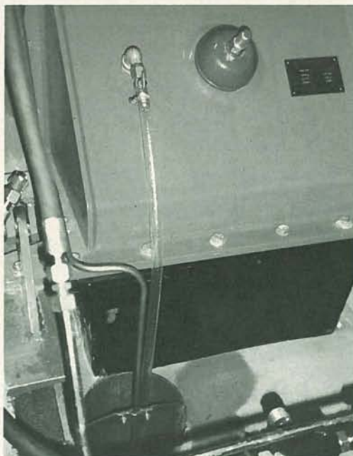
Turbine: Das durchsichtige Schläuchlein zeigt den Wasserstand im Saugrohr an.
